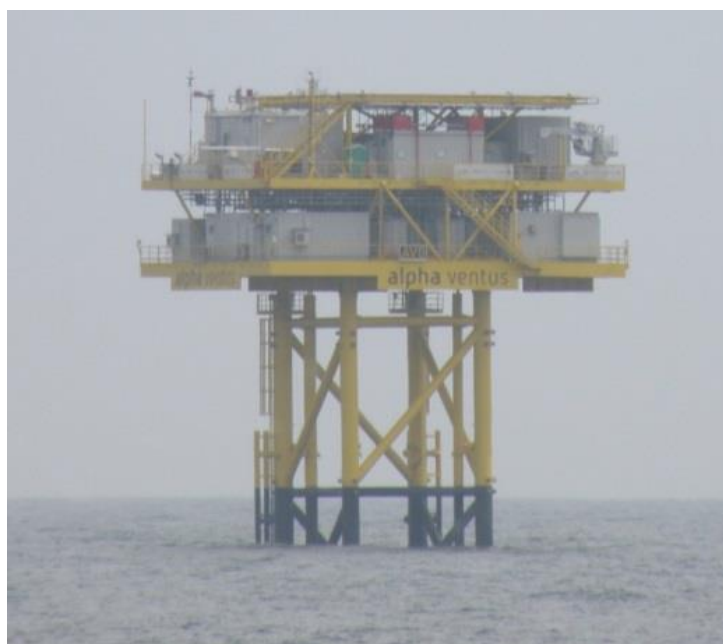
Fotografia 1. Morska stacja elektroenergetyczna
